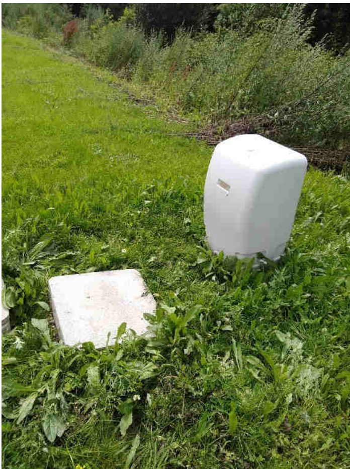
Photo armoire de commande fermée
